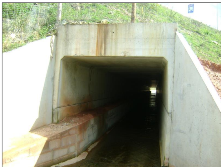
Figura 5 – Ponto de recolha de águas superficiais – PH 10.1 – Montante.
